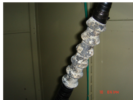
圖 16：電纜頭的沿面閃絡痕跡
