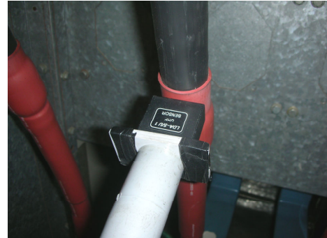
圖 5：電纜頭局部放電現場實測
